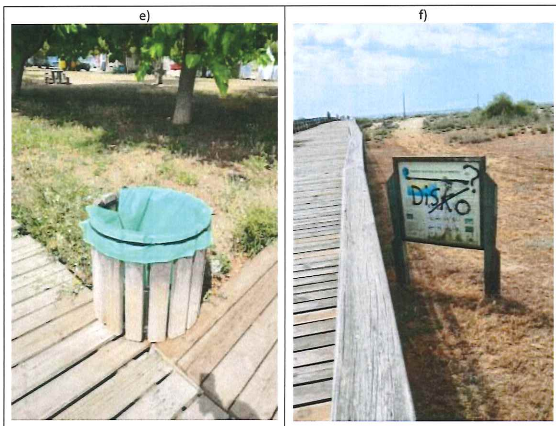
Figura 11 – Fotos exemplificativas de algumas das estruturas que necessitam de intervenção na área do PNRF (continuação):
