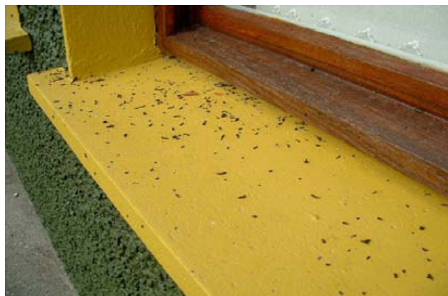
Figura 11 – Acumulação de guano no parapeito de uma janela, usada para acesso de morcegos (Kelleher & Marnell (6) ).
