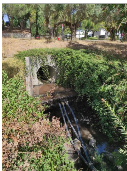
Figura 6. Escoamento dos lagos do parque empresarial que desaguam na ribeira das Parreiras
